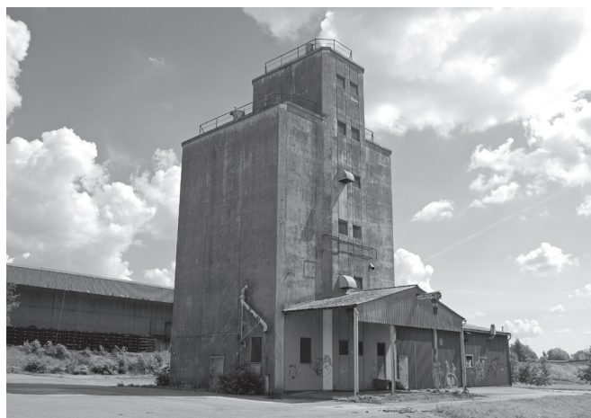
Bild 17. 2011 Användningen av silon har upphört. Färgen flagnar av och byggnaden förfaller.
